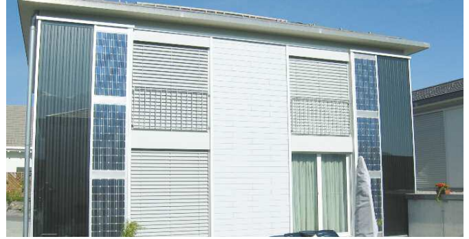
Solaranlage an Fassade
