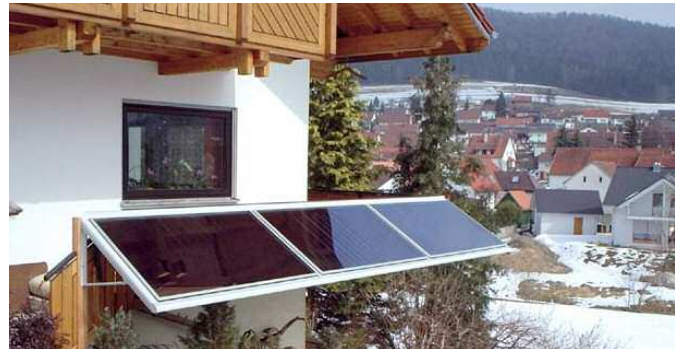
Solaranlage an Fassade
