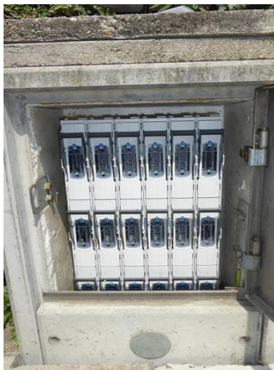
Neuer Innenausbau der Verteilnkabine 27 Neuenackerstrasse 43
