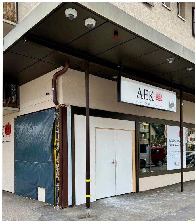
Die betroffene Bank in Hünibach.
